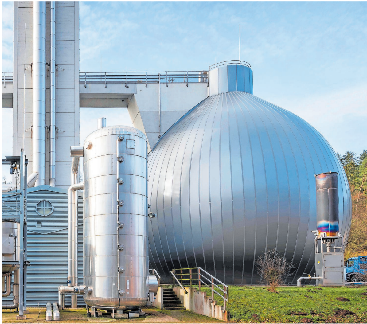
In der Kläranlage der STE entsteht aus Methangas Strom, sie soll mit den Fördermitteln um einen Gasspeicher erweitert werden. Das Foto zeigt einen der beiden Faulbehälter.
