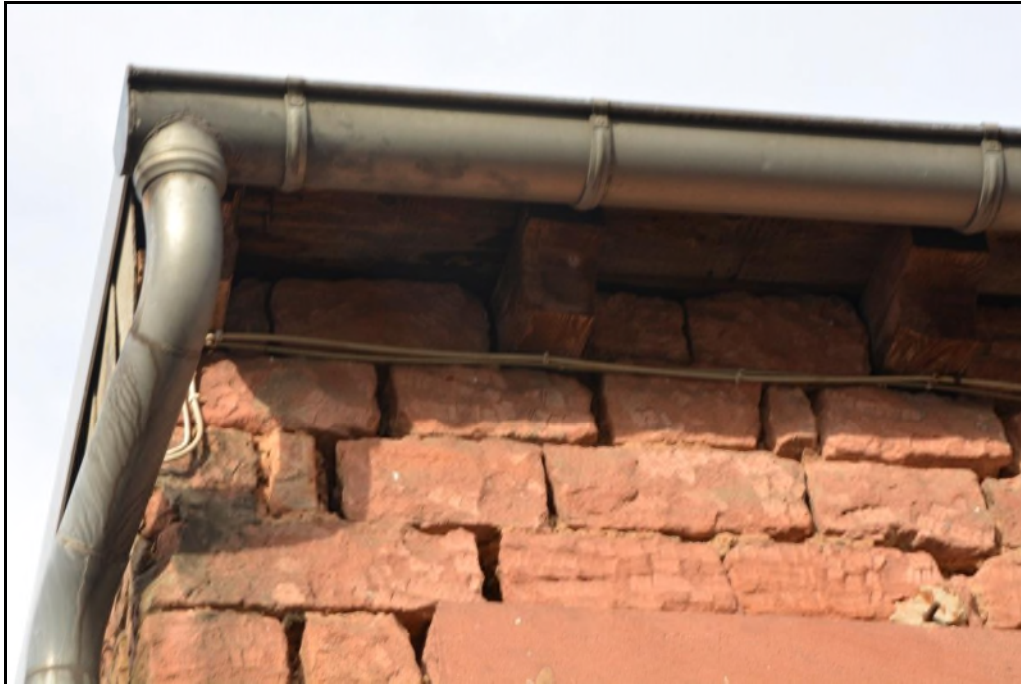
Abb.12: Detailansicht des Dachbereichs von Gebäude 6. Mehrere Fassadenspalten sind deutlich zu erkennen.
