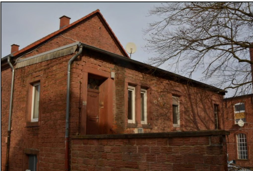
Abb. 11: Gebäude 6 weist mehrere kleine Öffnungen an Hausfassade und Dachbereich auf
