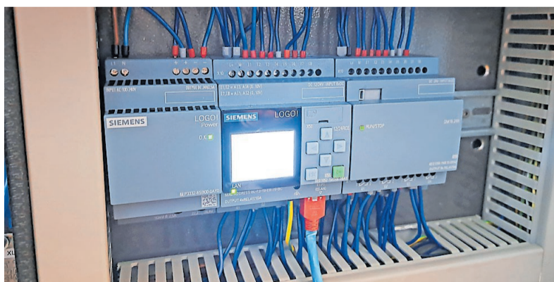
Eine der Steuerungsanlagen, die die Firma Wipotec der BBS I gespendet hat FOTO: BBS I TECHNIK
