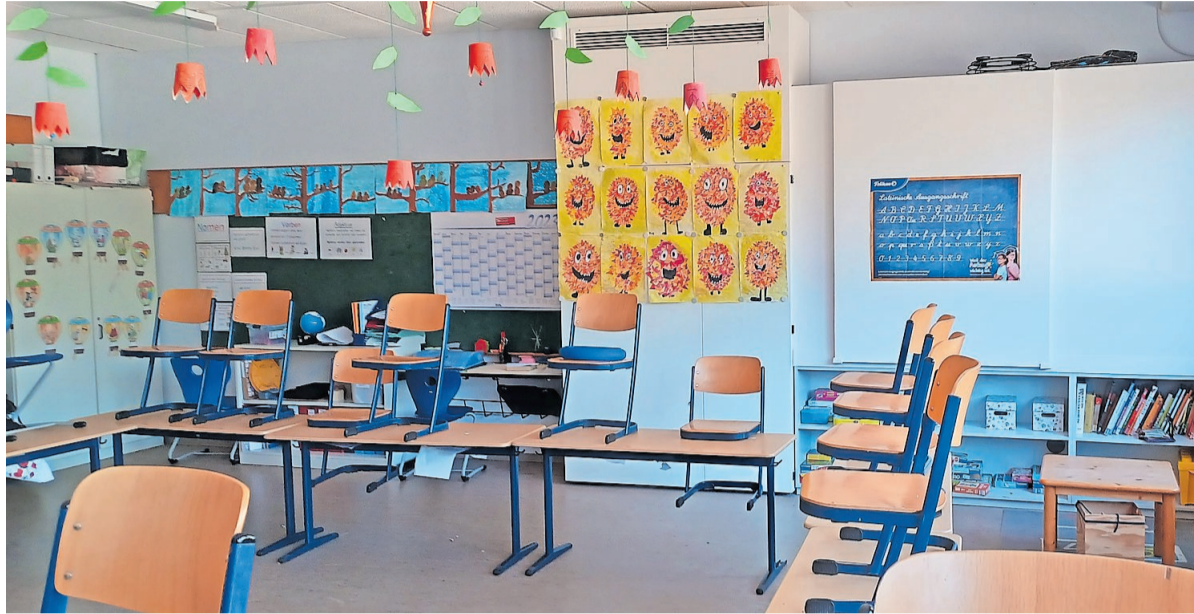
Die - bereits bunt beklebte - Lüftungsanlage im hinteren Teil eines Klassenzimmers der Grundschule Morlautern.
